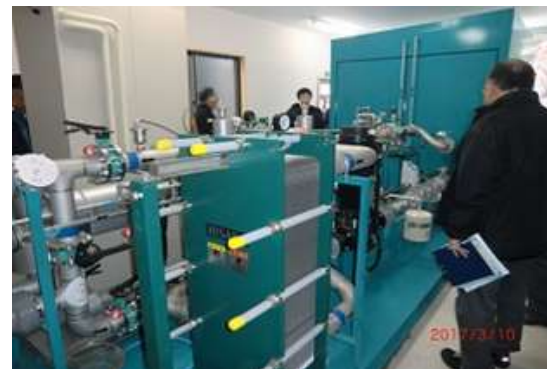
那須温泉バイナリー発電設備
